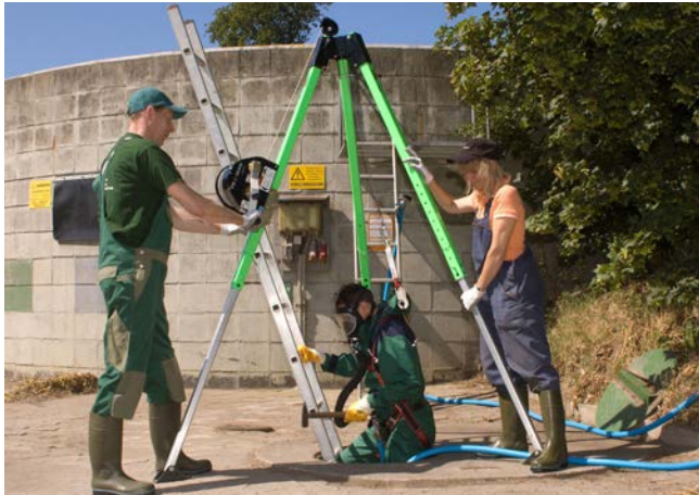
Einstieg ins Güllelager am Rettungsgurt mit einem umluftunabhängigen Frischluftgerät – gesichert durch zwei Personen. Foto: SVLFG
